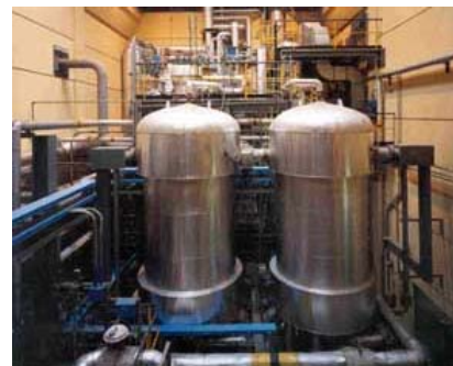
Interno della Centrale
